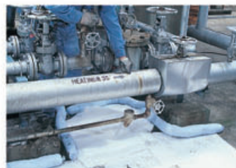
作業中の漏油に
